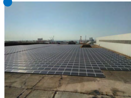
Centrale solaire sur toiture en zone portuaire
