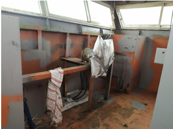
Débâclage complet du navire
