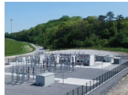
Poste source Express Enedis
